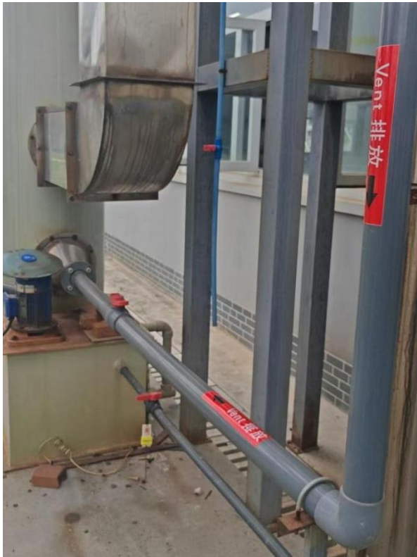
硝酸铵储罐呼吸废气收集管道
