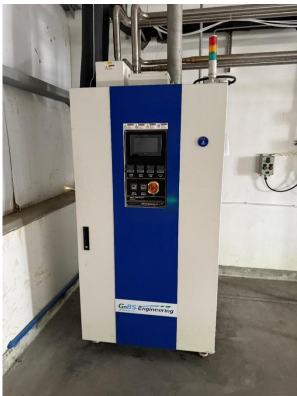
混合气充装废气处理设施-电加热+水洗
